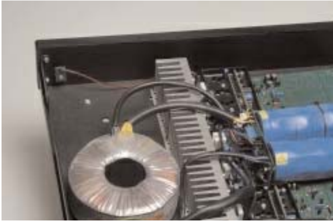
Στο εσωτερικό του Lato δεσπόζει ο μετασχηματιστής τροφοδοσίας και οι δύο μεγάλοι ηλεκτρολυτικοί. Η ψύκτρα είναι εσωτερική.
