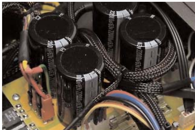
Το τροφοδοτικό του τελικού είναι γραμμικό. Χρησιμοποιεί 4 πυκνωτές των 22.000μF και γρήγορες διόδους της Philips.
